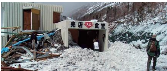
写真1 富士宮口五合目レストハウスの被災状況
