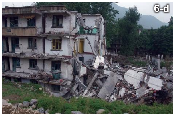
写真6 小魚洞鎮断層近傍の被害状況。
