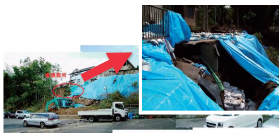
写真2 工事中の斜面が雨で崩れた例
