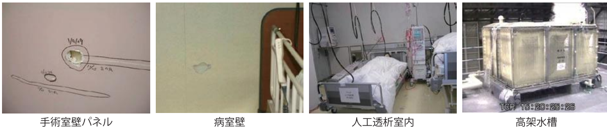
写真3 免震構造における長周期地震波加振後の室内状況
