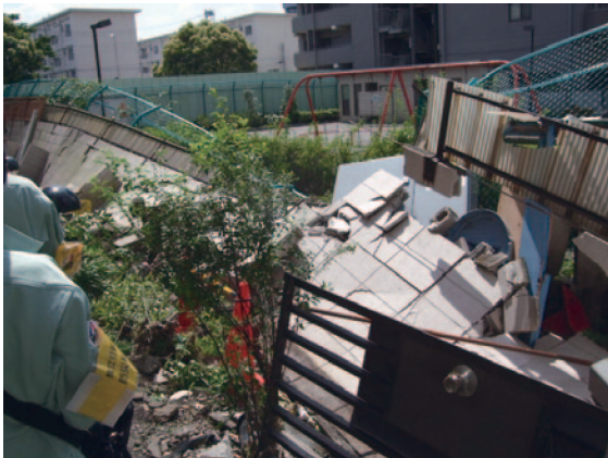
写真1 平成22年7月5日豪雨による被害の例。氾濫した水の圧力によってブロック塀やドアが倒されています。
