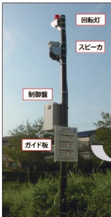
写真2 いたち川（横浜市）に設置されている警報装置
