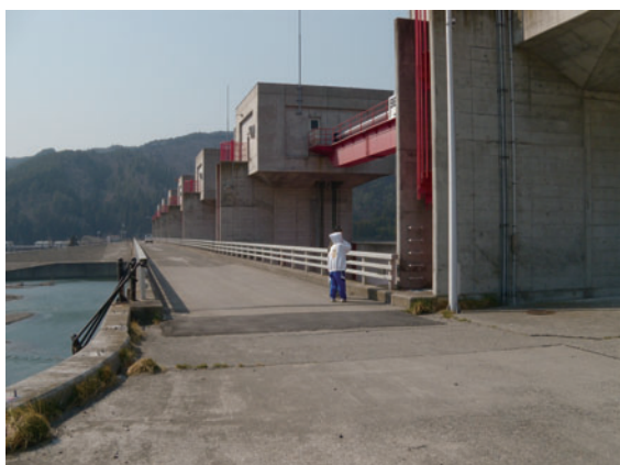
写真8 山側から見た小本水門。普代水門に見られたような連絡用の道路橋の損傷(写真12)は見られない。つまり、津波がほとんど越流しなかったことを示している。
