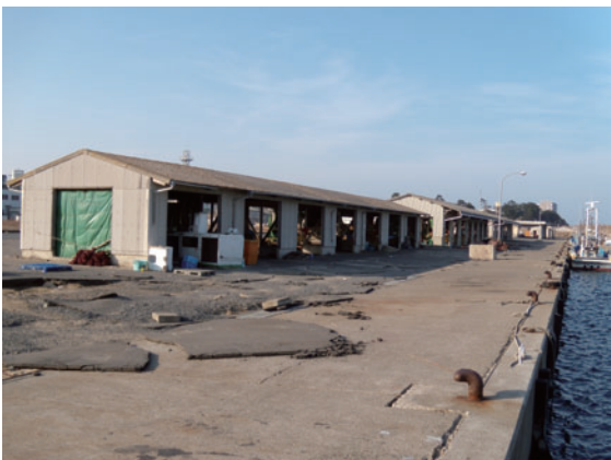
写真4 津波の被害を受けた那珂湊港。
