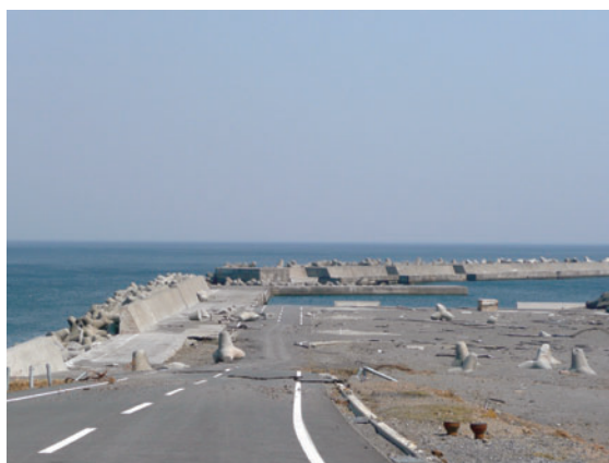
写真9 破堤した海側の防潮堤と津波により数10m流された20tのテトラポット。この場所の陸側にもうひとつ防潮堤(写真10)がある。
