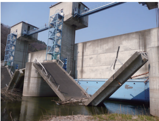
写真12 山側から見た普代水門。越流した津波により連絡用の道路橋が損傷している。小本地区よりも津波高が大きかったことを示している。
