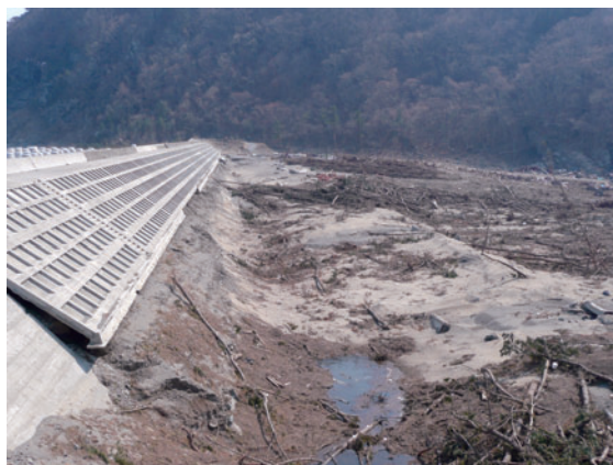
写真10 小本水門に隣接する防潮堤。防潮堤脇が津波により洗掘されている。
