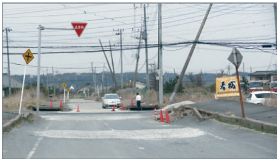
写真1 歩道下の水路の浮き上がり、電柱の傾斜(神栖市平泉)
