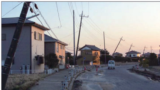
写真2 干拓地のほぼ全域で液状化が発生し、多くの電柱が傾いた様子(潮来市日の出)
