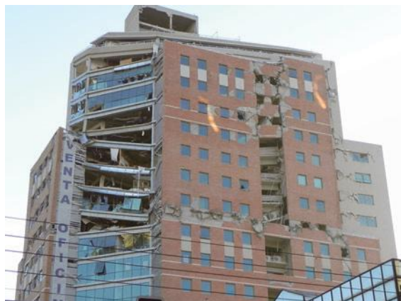
図3 2010年チリ地震による建物の被害
