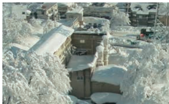
図1 湯沢発電所の建物の屋根崩落
