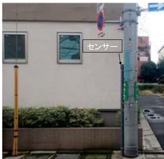
写真1 電柱に設置された道路冠水深計測センサー
