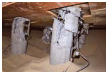
写真2 加振により損傷した杭
