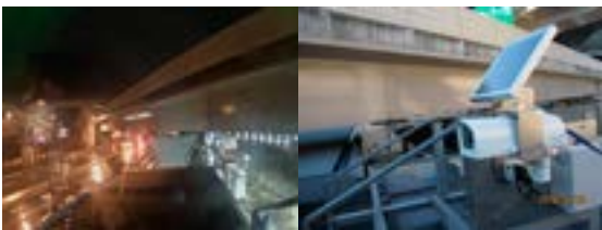
図4 Webカメラ(右)による橋桁監視(左)
