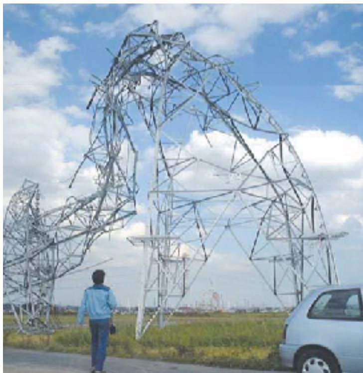
図2 台風21号の強風で倒壊した送電鉄塔（茨城県潮来市米島・平成14年10月2日午後3時頃、東北東を向いて撮影）。
