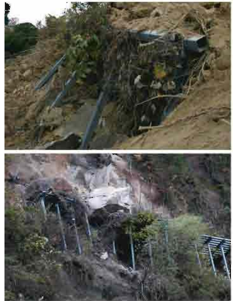
図1 地震による斜面崩壊で土砂や樹木（上）、巨大な岩石（下）が堆積した雪崩予防柵
