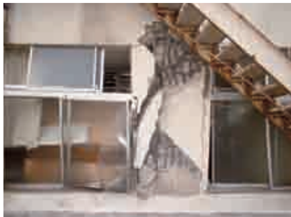
写真1 新潟県中越地震における医療機関の被害
