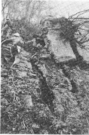
写真 32 赤砂川左岸の斜面の亀裂(対岸の崩壊による衝撃によるものと思われる).
