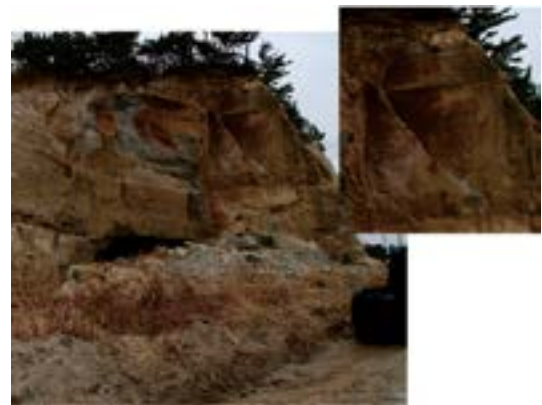
写真1 松川浦大橋東側法面崩壊（3月20日撮影）
