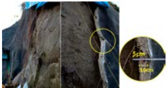
写真4 左側(南側)・右側(北側)モルタル切断面と背後地盤との間の状況 (3月22日撮影)
