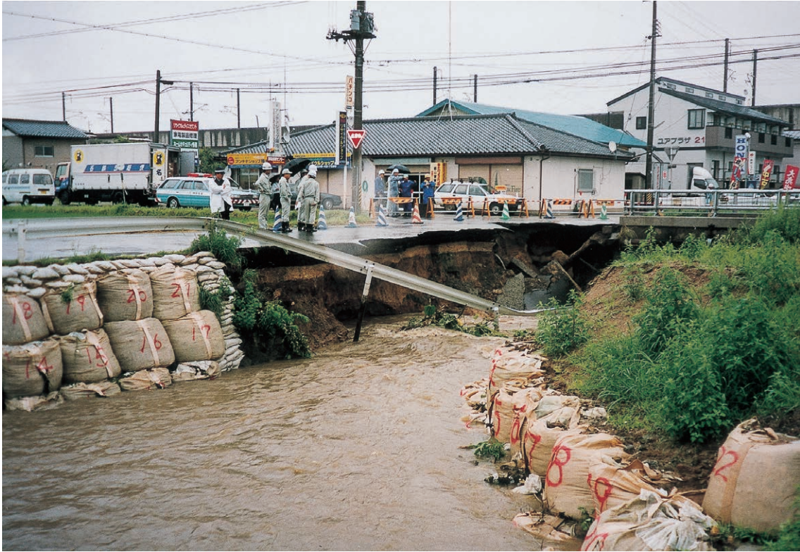
口絵 7 応急対策現場 (郡山市河川課提供)
