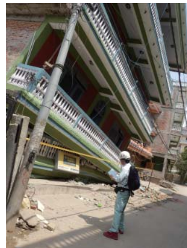
写真17 チャリコットの被災状況 Photo 17 Damage in Charikot.
