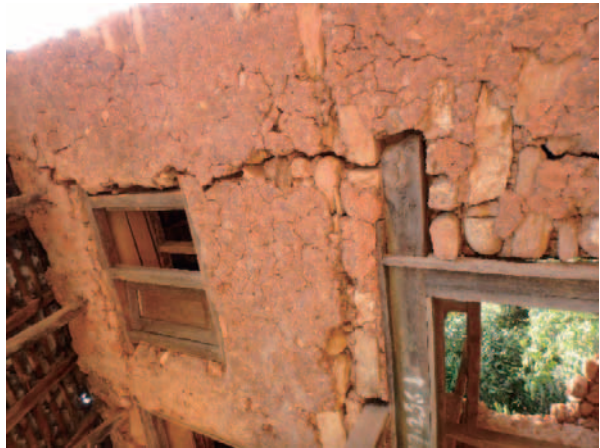
(b) 窓枠付近に生じたクラック・変状
