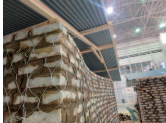
(g) 壁の変形(面外方向)
