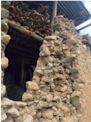
(a) 玉石を用いた壁の崩壊
