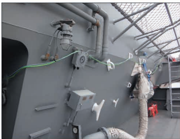
通信試験準備の様子(屋外配線)①
