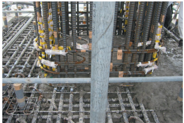
写真 5.2 フーチングの配筋と PFRC の打設 Photo 5.2 Construction of the footing.
