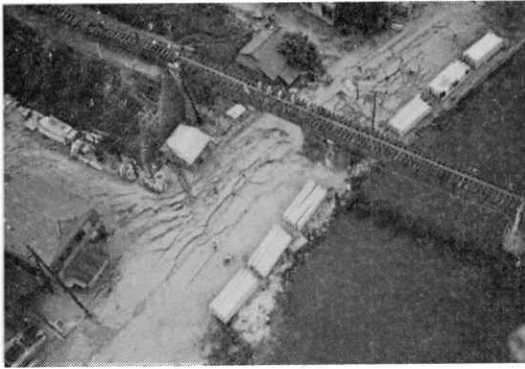
写真-2 信濃川橋梁 1A, 1P 付近川岸の移動と地表面のクラック状況
