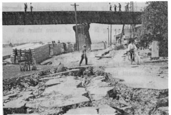
写真—1 越後線信濃川橋梁1号ピアの傾斜 Titling of pier No. 1, Shinanogawa Bridge.
