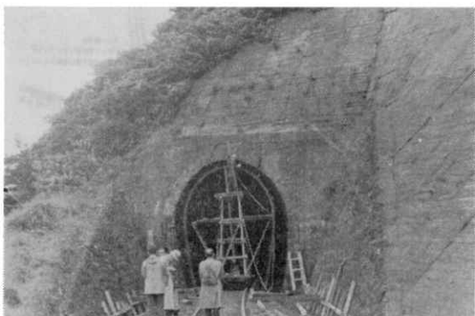
写真1 鼠ヶ関トンネル坑口壁の亀裂状況 Cracks of portal, Nezugaseki Tunnel.
