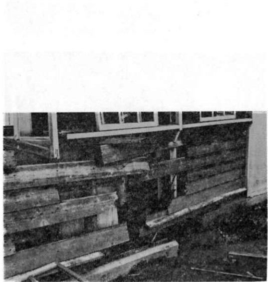
写真—26 布基礎の破断と移動（新潟市大形小 学校第4校舎北側） Breakage and dislocation of the continuous footing.
