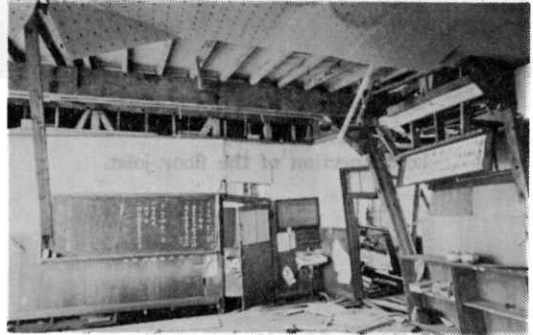
写真—18 壁および天井の被害と火打梁のはずれ（新潟市大形小学校第4校舎）
