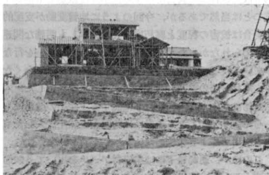
写真四 砂丘斜面にあるひな段宅地の被害(新潟市青山) Damage to home lets in tiers on the slope of dune.
