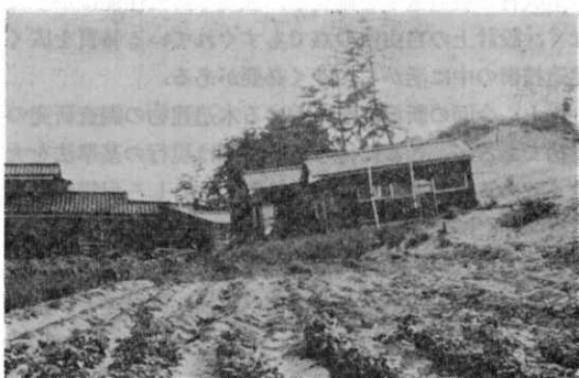
写真五 砂丘斜面における地すべりによる被害(新潟市青山) Damage by landslide on the slope of dune.
