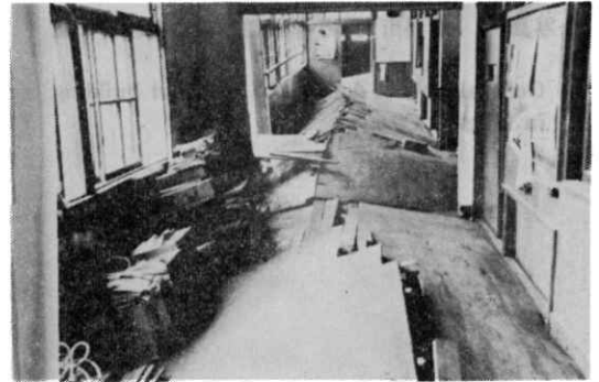
写真-14 廊下の被害(新潟市曾野木中学校より借用) Damage to the floor at a corridor.
