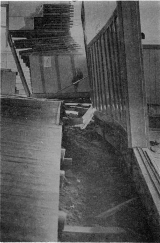
写真—16 床と壁の接合部の破損（新潟市曾野木小学校屋内運動場）
