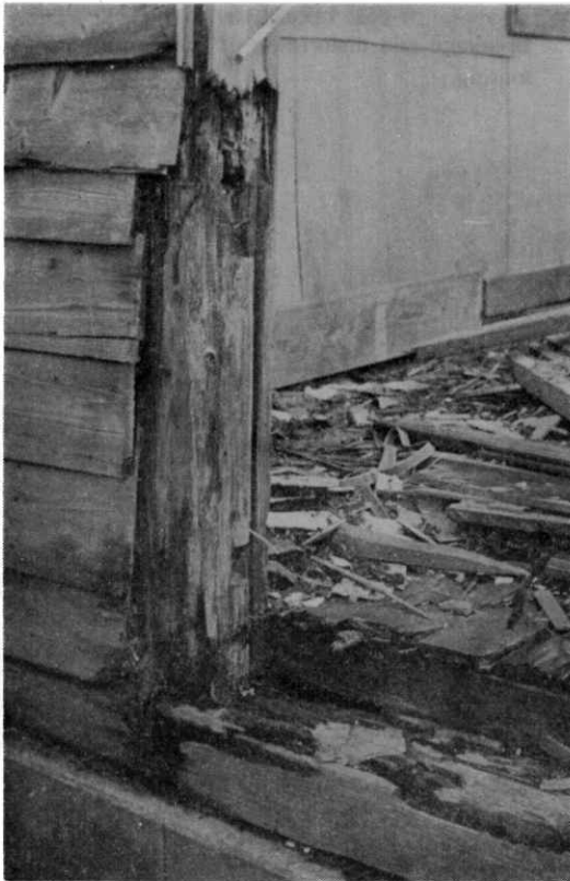
写真—29 柱の腐朽(鶴岡市京田小学校・幼稚園) Decay of the post.
