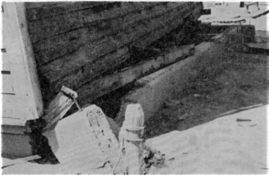
写真—25 布基礎および土台の破壊（新潟市大 形小学校第4校舎東側） Damage to the continuous footing and the ground sill.
