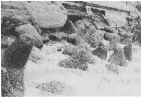
写真10 護岸基部の磨耗状況とほとんど原形を失った消波ブロック
