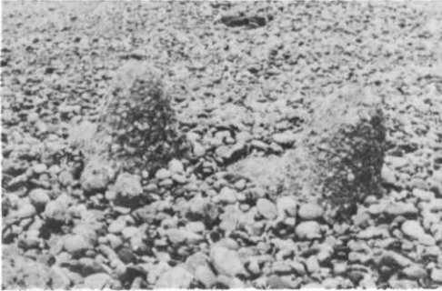
写真9 磨耗のためほとんど原形を失った消波ブロック
