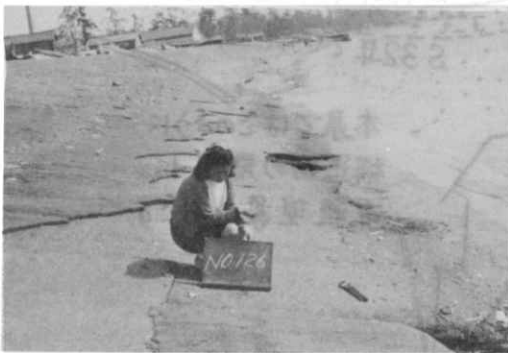
写真1 昭和42～44年施行のアスファルト護岸 本県でもこのようなゆるい傾斜度の護岸はめずらしい。
