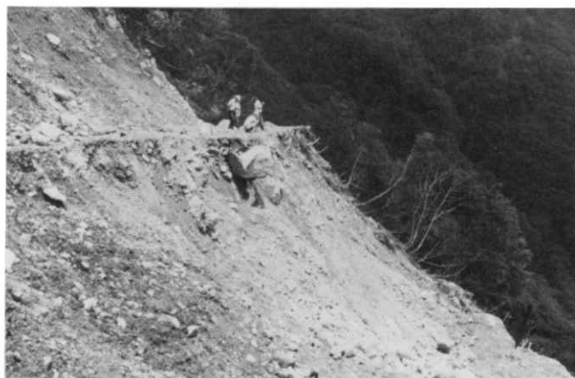
(2) 夏期（7月4日），矢印は陥没した道路の一部
