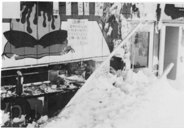
(3) 内部への雪の侵入状況
