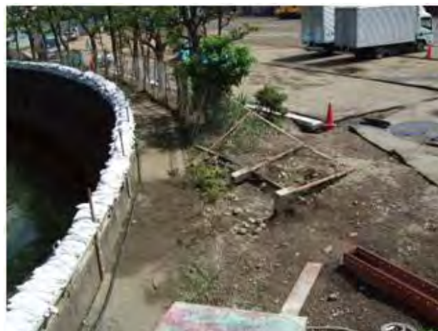
図 6 石神井川溢水箇所
