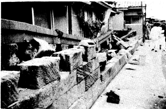
写真25～28 これらの写真にみられるように、 ブロック積みや石積の建造物のこわれ方が目 立った。
