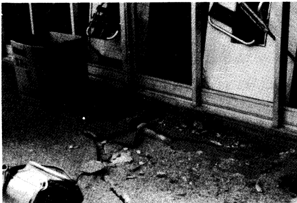
写真一 2 4 水道管の接手部分と埋め込んだ路盤の破壊状態(11日石廊崎)
