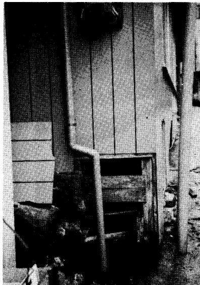
写真 1 1 湯布院町湯の平の家屋の被害
