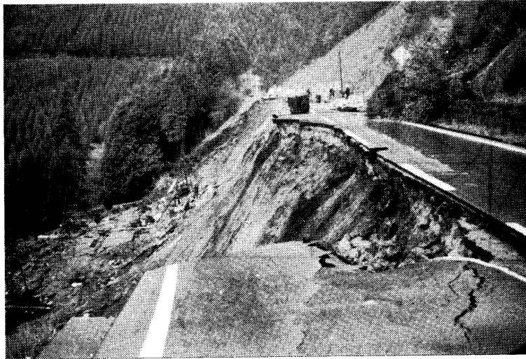
写真 2 九州横断道路の崩壊（山下池の上）
