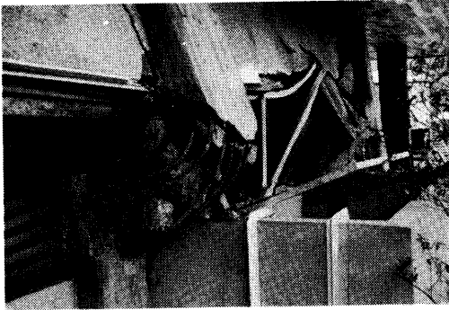
写真 2 0 Cブロック外側柱の破壊
