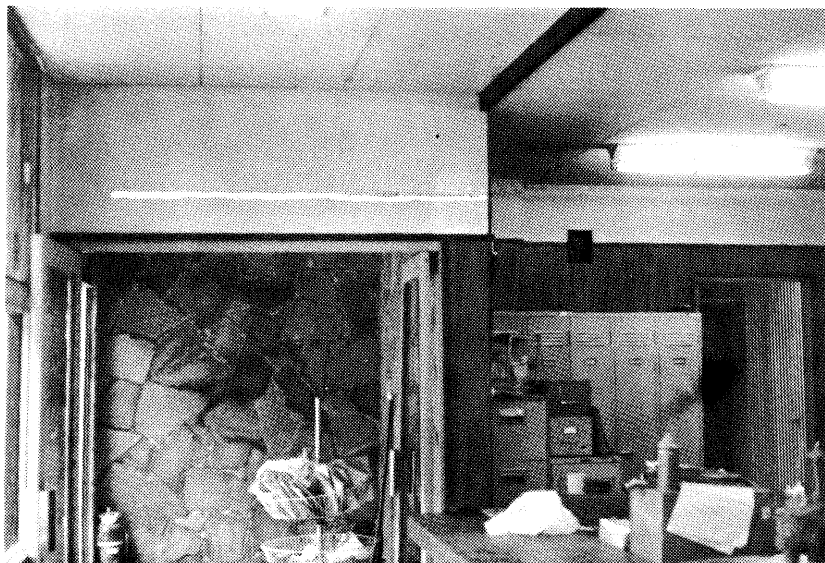
写真-4 池川町土居農協浸水痕跡
