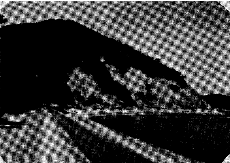
写真 33 海蝕崖の崩壊(蒲野付近)
