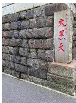
崩れかかった石垣
