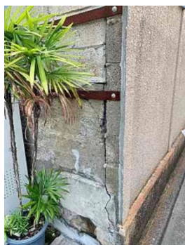
ブロック塀クラック
