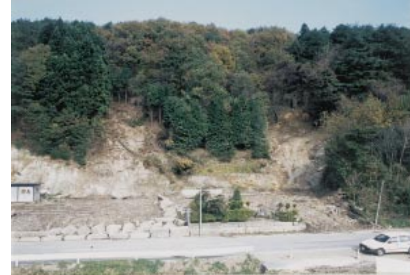
写真10 葎ノ目の崩壊跡地 Photo 10 Source of the Yoshinome landslide.
