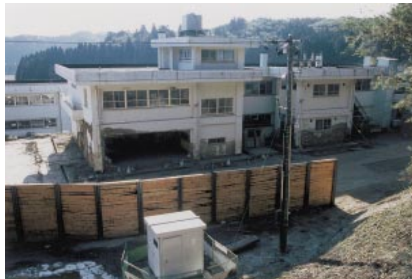
写真13 大信中学校裏の崩壊による校舎の被害状況 Photo 13 Damaged building of Taishin junior high school.
