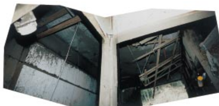
写真3 土砂により破壊された「からまつ荘」5号室の天井 Photo 3 Destroyed ceiling in Room 5 of Karamatsu-sou.
