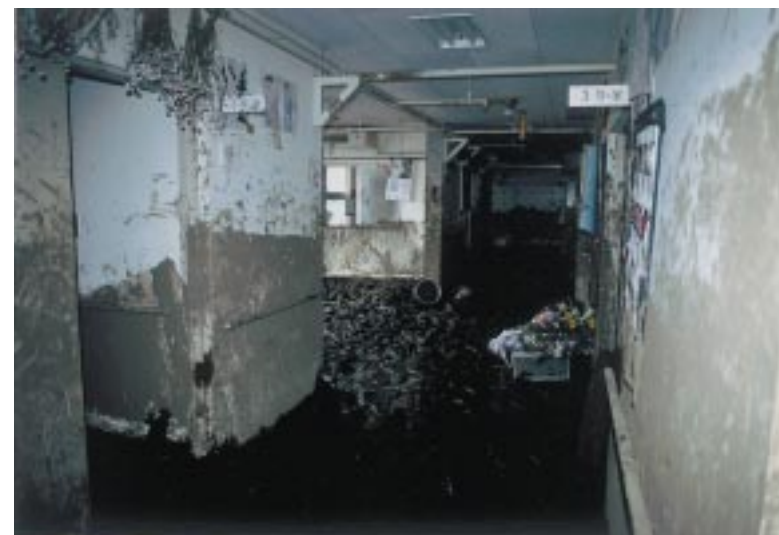
写真4 「からまつ荘」1階の廊下の被災状況 Photo 4 Damaged section of Karamatsu-sou.
