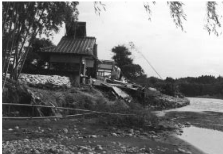
写真7 洪水流の直撃により損壊した家屋 Photo 7 A home damaged by the direct hit by flood waters.
