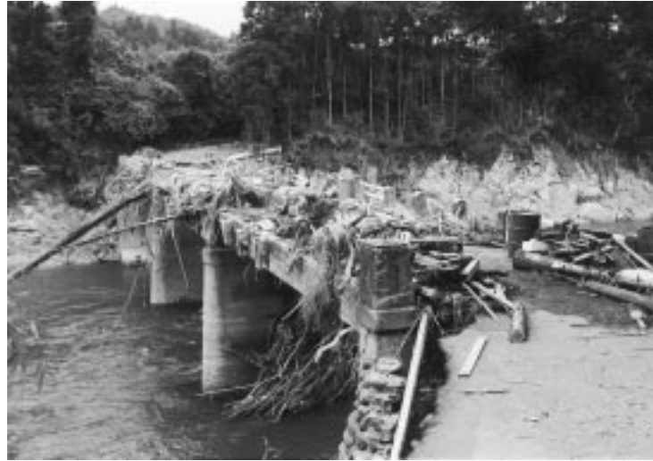
写真 10.3 余笹川最下流部橋梁の被災状況 [ 黒羽町提供 ]
