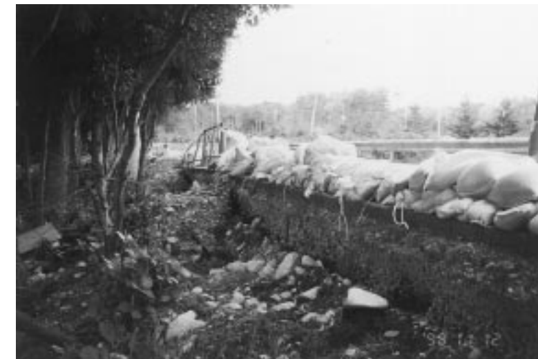
写真11.2 那須疎水からの氾濫流による洗掘
