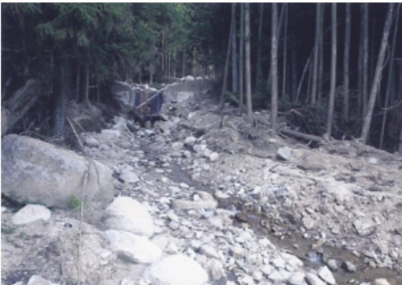
写真 12b 土石流が流下した溪流の被災状況（根羽村初入付近）
