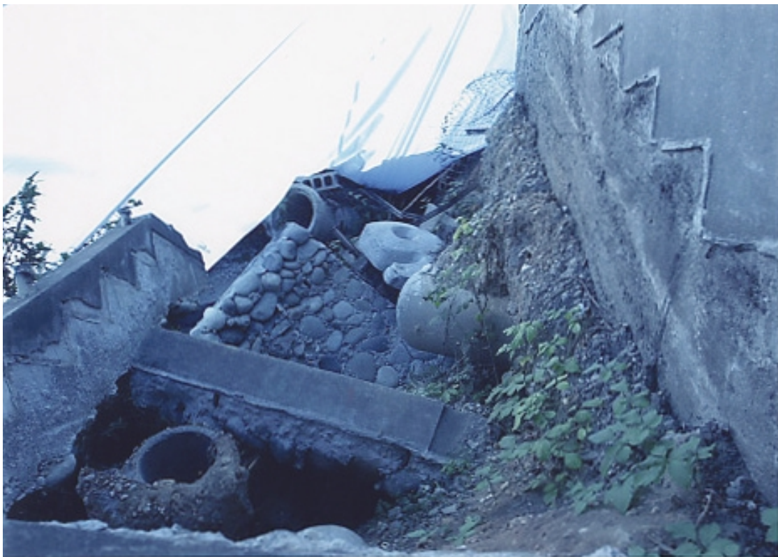
写真2b 崩壊地内の破損した排水管の状況
