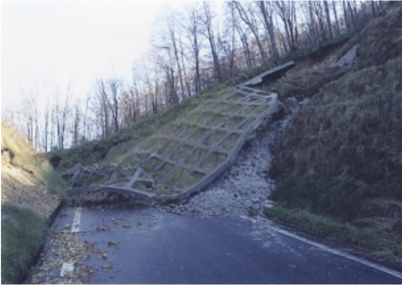
写真 12a 林道における法面崩壊（ヤハズ峠付近）
