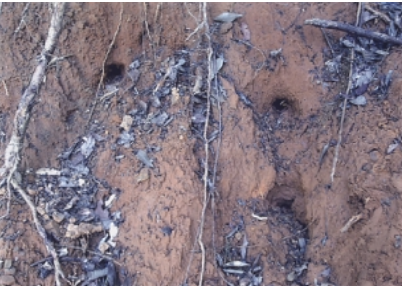
写真 6b 小牧市大山崩壊地内のパイピング穴 Photo 6b Piping holes on the Landslide.
