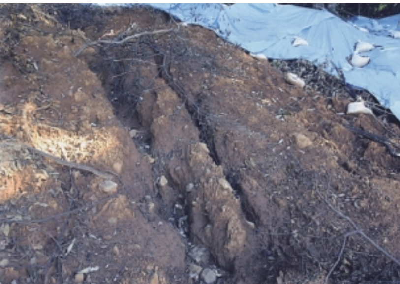
写真 6c 小牧市大山崩壊地内のパイピング穴 による表面侵食 Photo 6c Erosion on the Oyama landslide by pipeflow.
