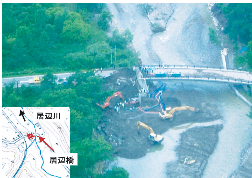
写真 3 上士幌町の居辺(おりべ)川に架かる居辺橋の左岸側道路の陥没状況。ここで、ワゴン車が転落し、乗っていた5名が川に流され死亡した。北海道庁提供_台風被害状況資料/台風10号十勝支庁管内の被害写真 (URL: www.pref.hokkaido.jp/soumu/sm-bsbou/typhoon-10/tokati.htm )
