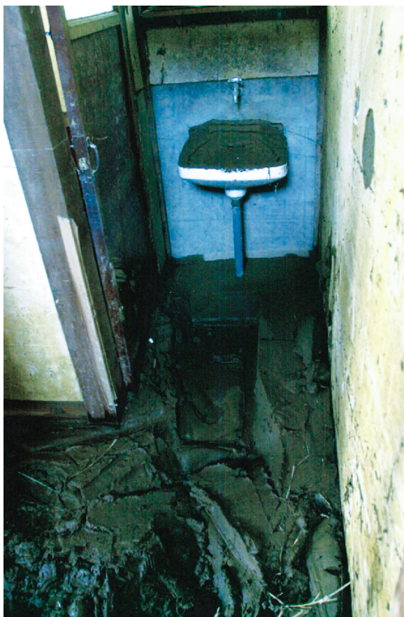
写真4 室内に堆積した泥状の土砂 Photo 4 In doors muddy sediment by flood.
