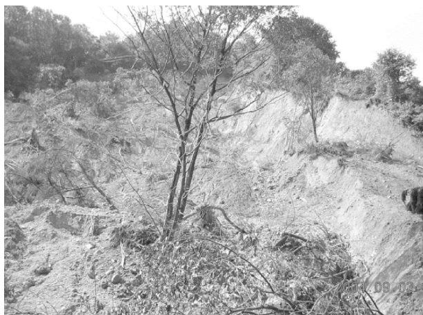
写真 1 栃尾市土ヶ谷で発生した斜面崩壊（表 2 の地点 6） Photo 1 Landslide at Tsuchigaya, Tochio City (No.6 in Table 2).
