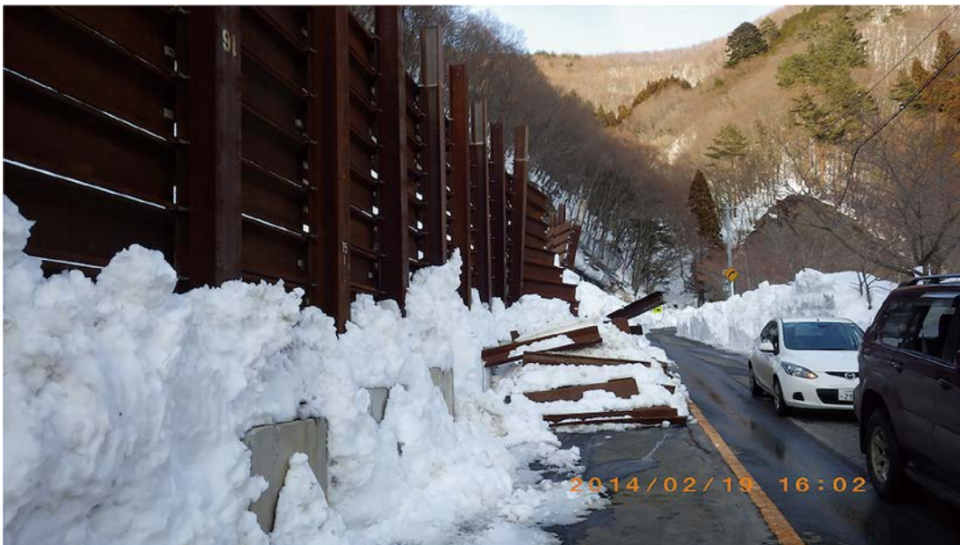
口絵 18 雪崩で破壊された道路脇の落石防護柵（国道 300 号，山梨県本栖湖付近，2014 年 2 月 19 日撮影） Fig. 18 Protection fence destroyed by an avalanche. (National Route 300, nearby Motosuko, Yamanashi : February 19, 2014)
