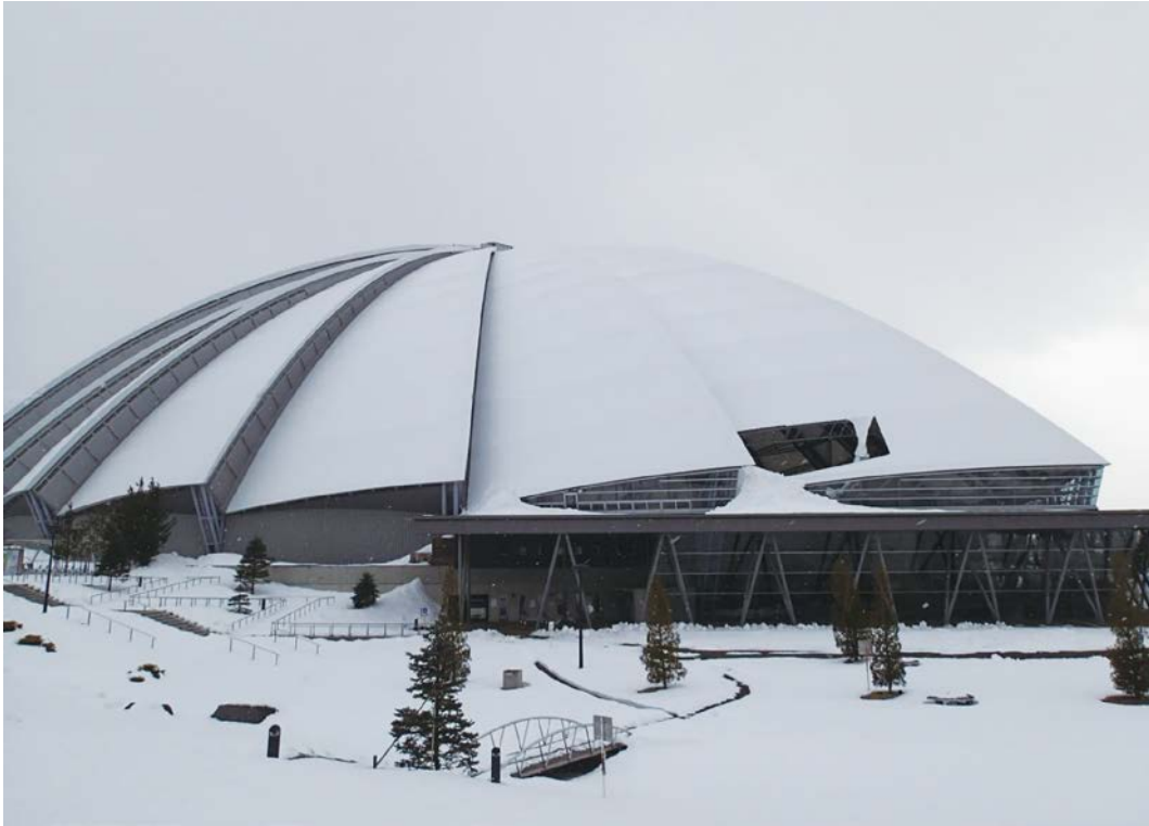
口絵 7 雪の荷重により破損した仙台市屋内グラウンド（シェルコムせんだい）のドーム部（2014年2月19日撮影）
