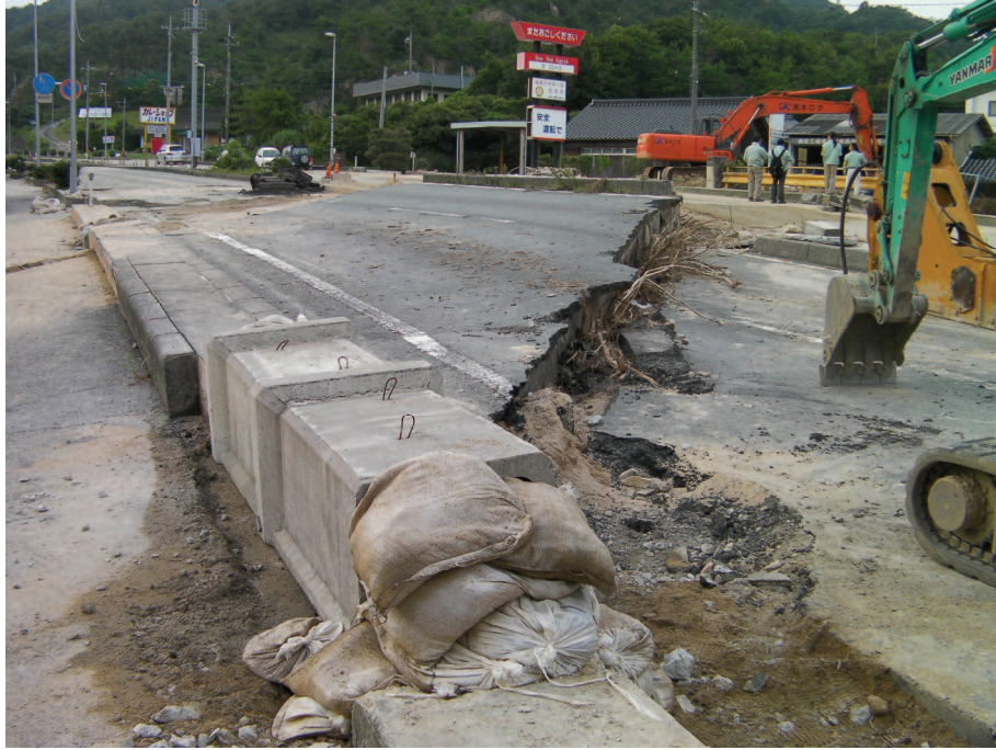
口絵 3 国道 262 号の被災状況。防府市下右田にて Fig. 3 Damages of National Route 262 at Shimo-Migita in Hofu city.
