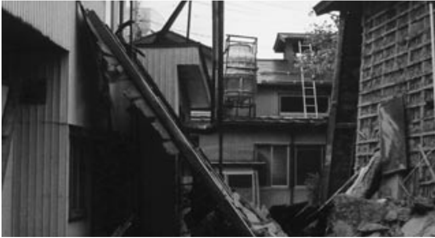
崩れ落ちた渡辺さんの店舗の壁。大規模半壊と認定された。
