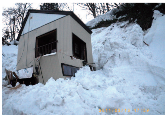
図5 地震による雪崩によって被災した建物(新潟県十日町市) Fig. 5 Damaged house by seismicity-induced snow avalanche.
