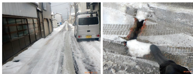
写真2 消雪パイプの機能が低下している道路と接合部が破断された消雪パイプ（富山県氷見市）
