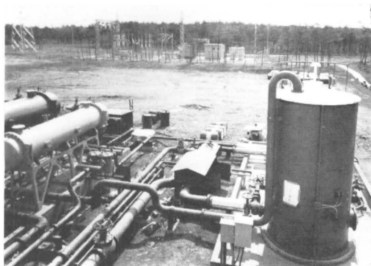
写真-3 油タンクおよび冷却設備
