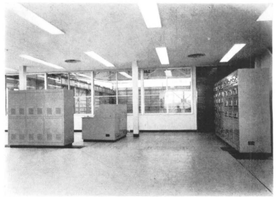
写真—6 制御用機器
