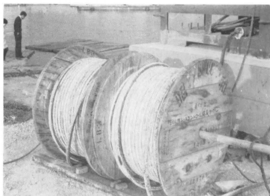
写真-2 水中用の鎧装ケーブル
