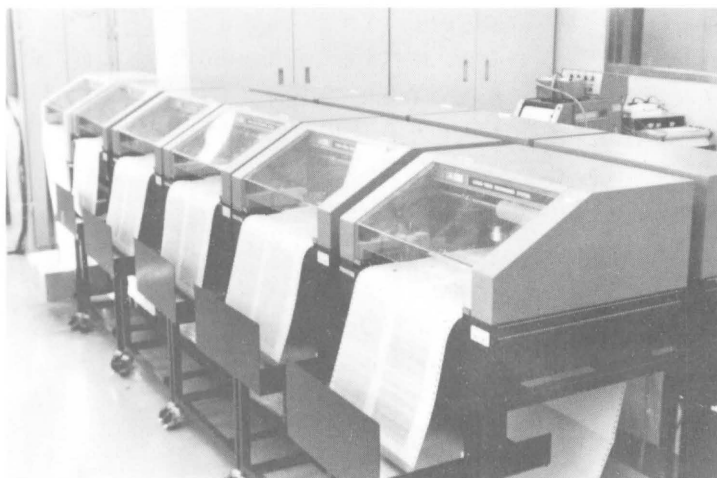
テレメータ室
