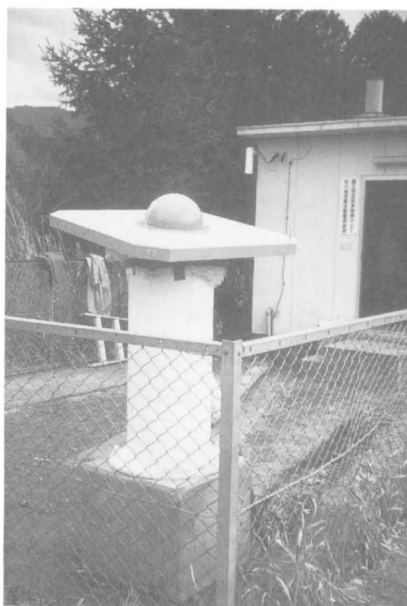
写真2 本川根地殻活動観測施設に設置されたGPS受信アンテナ
