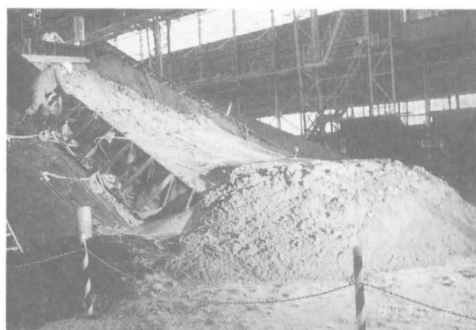
写真2. 崩壊後の状況
