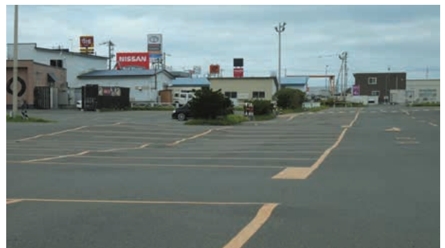
図10 新ひだか町静内の店舗駐車場の液状化(撮影日 9/16) Fig. 10 Liquefaction of store parking lot in Shin Hidaka Shizunai (shooting date 9/16).
