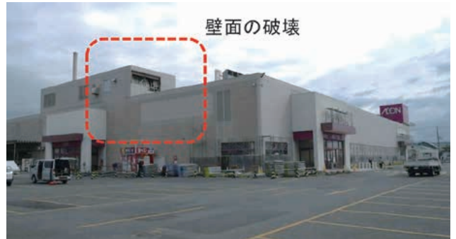
図9 新ひだか町静内の店舗外壁破損(撮影日 9/16) Fig. 9 Store outer wall damage in Shin Hidaka Shizunai (shooting date 9/16).
