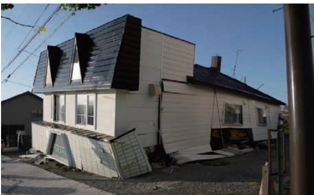
図7 むかわ町松風地区の家屋崩壊(撮影日 9/15) Fig. 7 House collapse of Mukawa Matsukaze district (shooting date 9/15).
