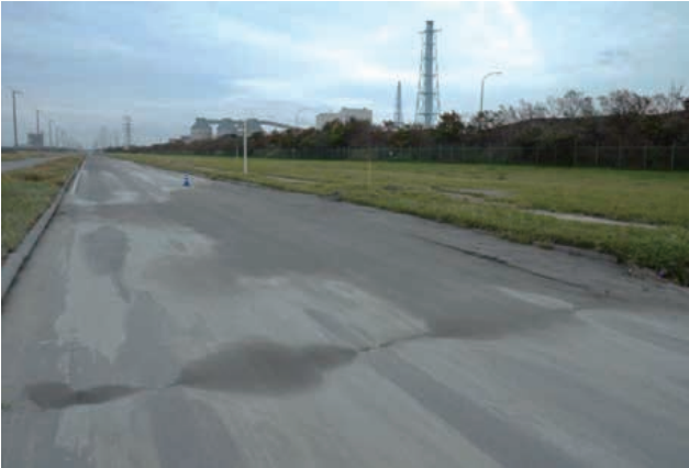
図6 苫東厚真火力発電所周辺の液状化(撮影日 9/16) Fig. 6 Liquefaction around Tomatou Atsuma thermal power plant (shooting date 9/16).
