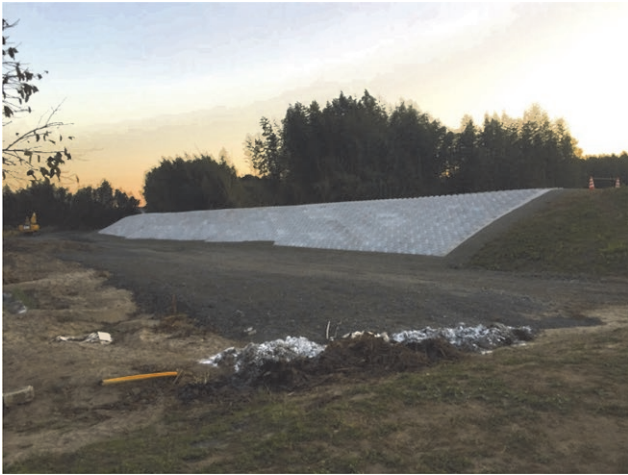
写真 7 松栄町の上流側にある堤防の決壊箇所 Photo 7 Embankment breach location on the upstream side of Matsuei-Machi.
