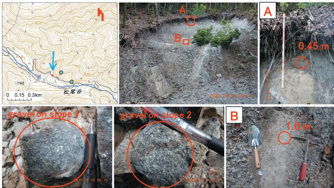
図 10 地点 14 (II 4 , 流紋デイサイト溶結凝灰岩) の斜面崩壊の様子。(左上) 斜面位置。赤色が斜面変動範囲で水色が土砂流出箇所。調査した崩壊地の斜面移動範囲は現地調査を元に加筆。背景は国土地理院の標準地図 (25,000 分の 1 地形図, 等高線間隔は 10 m)。(中央上) 崩壊地全景。(中央左下の 2 枚) 基盤岩と思われるやや風化した転石。(右上, A) 表層土層。(右下, B) すべり面の土層。表層土層 (0.45 m) は運積土, すべり面の土層 (1.0 m) は原位置風化土と思われる。赤丸で試料を採取した。
